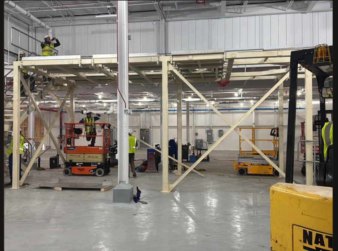
STRUCTURI METALICE ETAJATE
