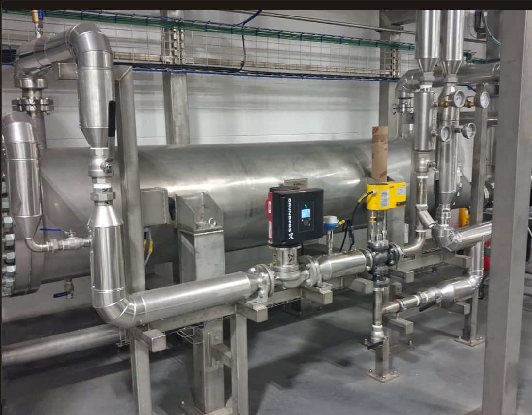
STAȚII SCHIMBĂTOARE DE CĂLDURĂ
